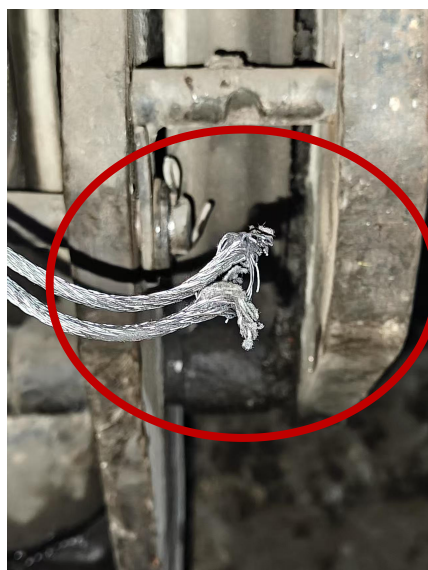
图 2 钢丝绳断裂状态
