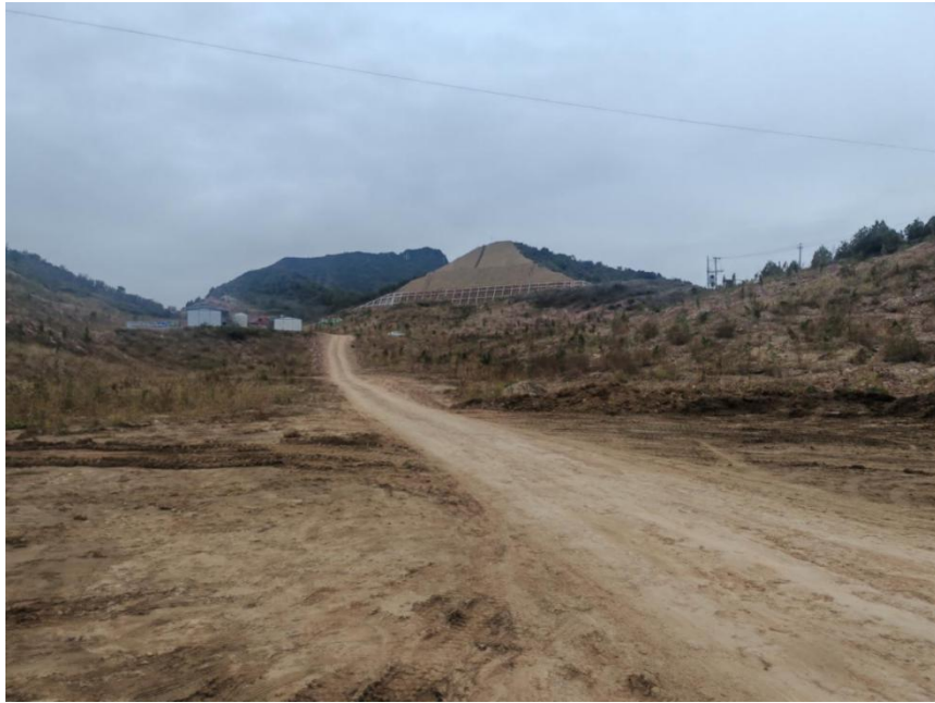
（事发现场勘验照片）
