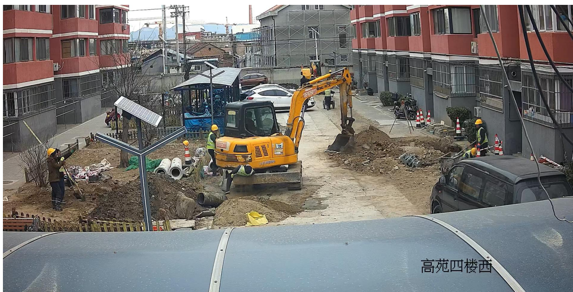
图2 事发时挖掘机状态
