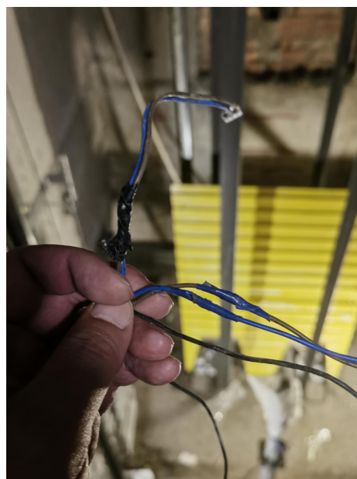
图 4 现场遗留的消防控制线路
