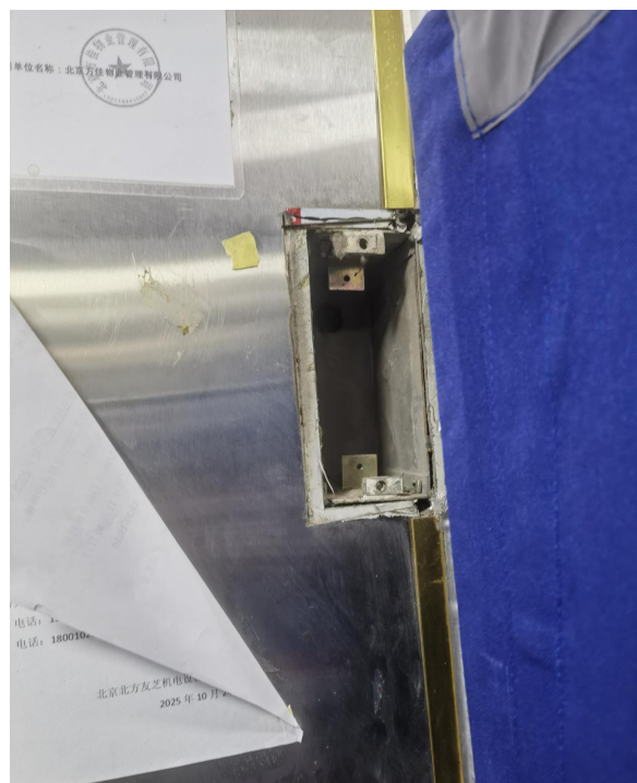
图 1 电梯消防开关盒未安装
