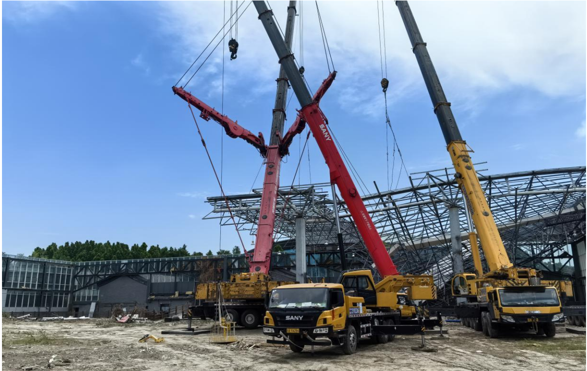
图3 事故现场钢架及吊车情况（此图为面向东方拍摄）
