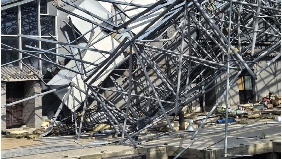
图2 网架坍塌情况及气瓶位置
