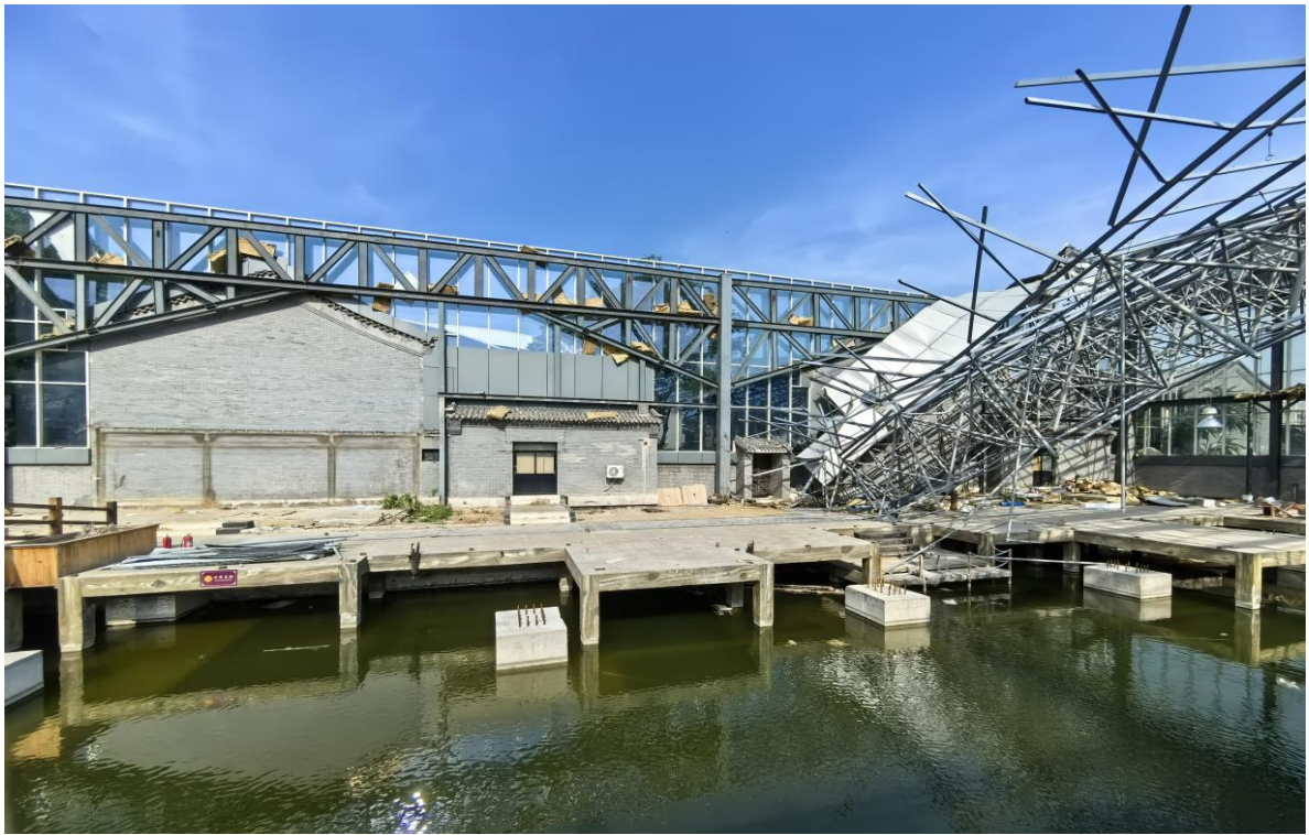
图1 南侧网架东北角坍塌情况（此图为面向东方拍摄）
