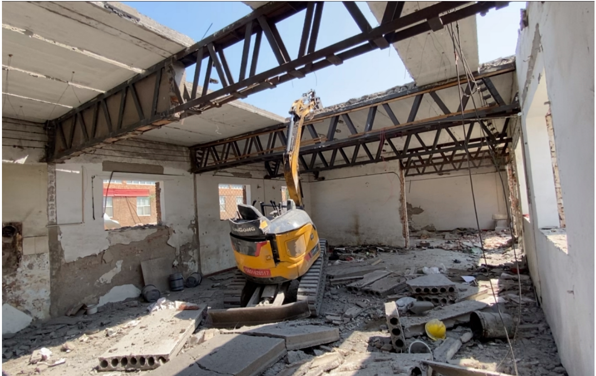
图9 挖掘机坠落现场及周边情况照片
