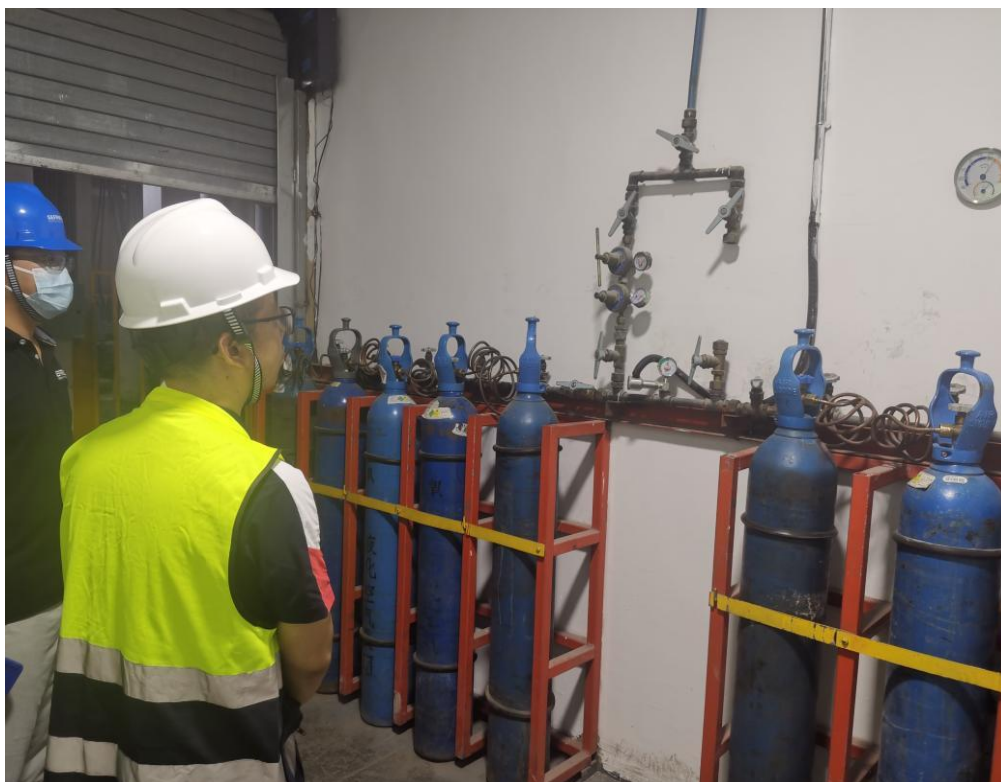
图 17 对氧气瓶使用间提出整改建议
