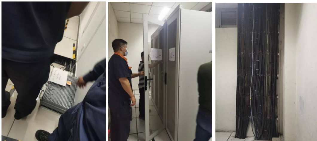
图 7 通信机房场所隐患
