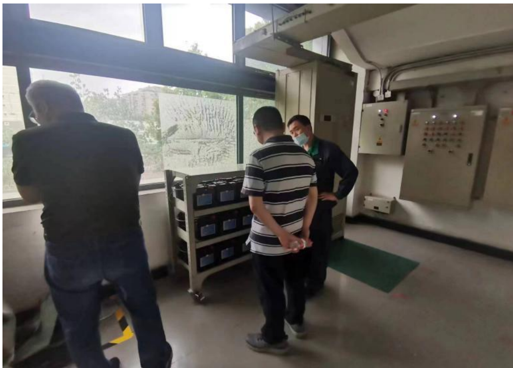
图 5 对配电间通风和降温提出整改建议
