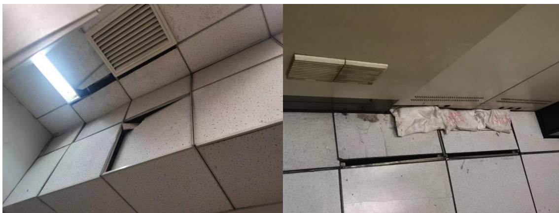
图 6 综控设备机房场所隐患
