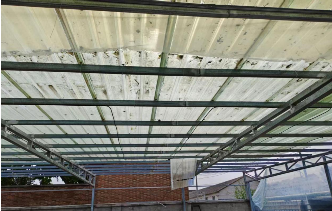
图 1 涉事钢结构罩棚结构和坠落点位照片
