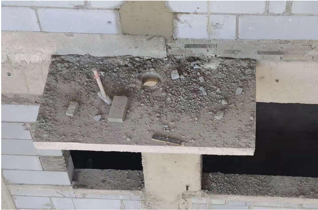
图 2 10 层空调台锤子放置情况
