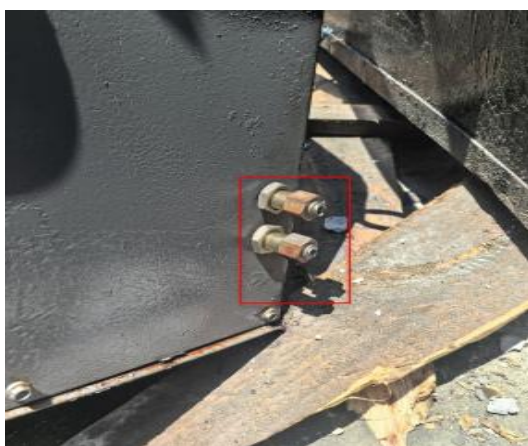
图 6 油泵油管连接处
