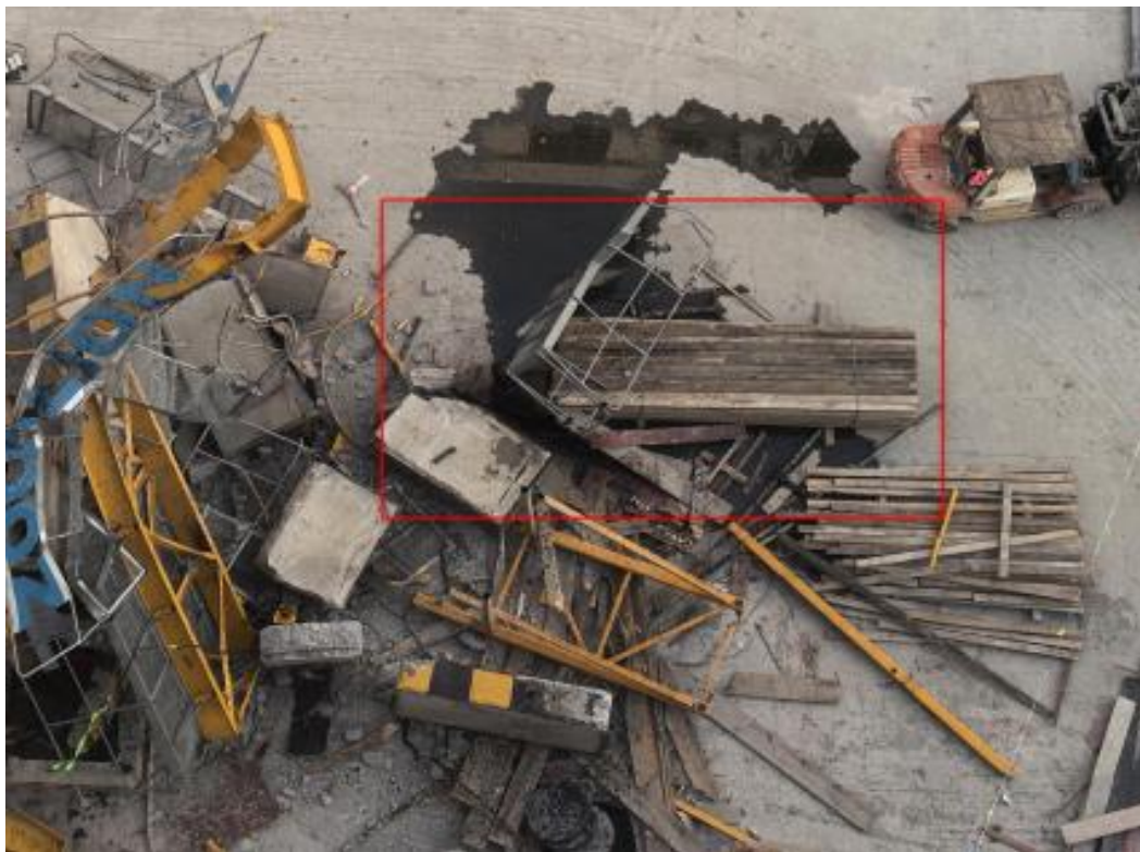
图 5 塔身西侧地面的液压油
