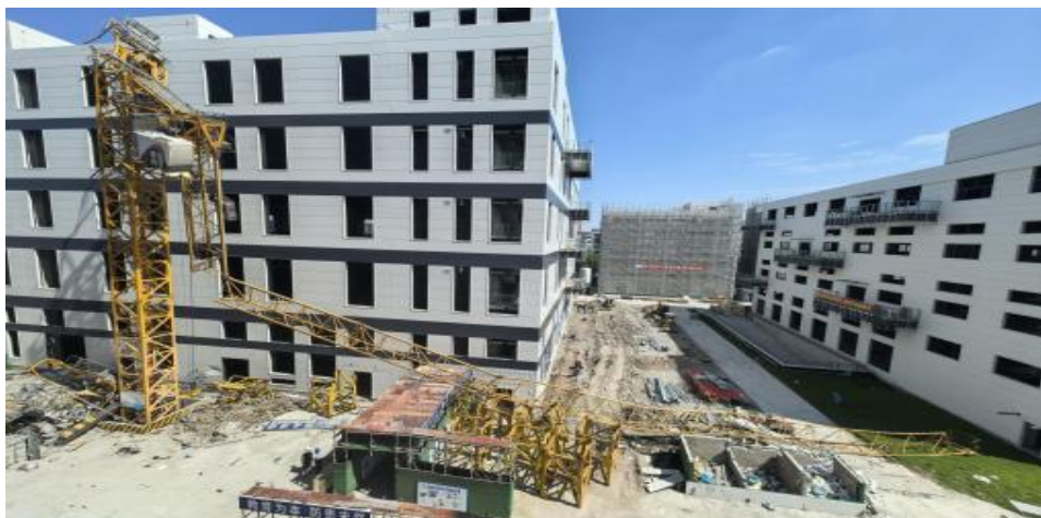
图 2 事故全景照片
