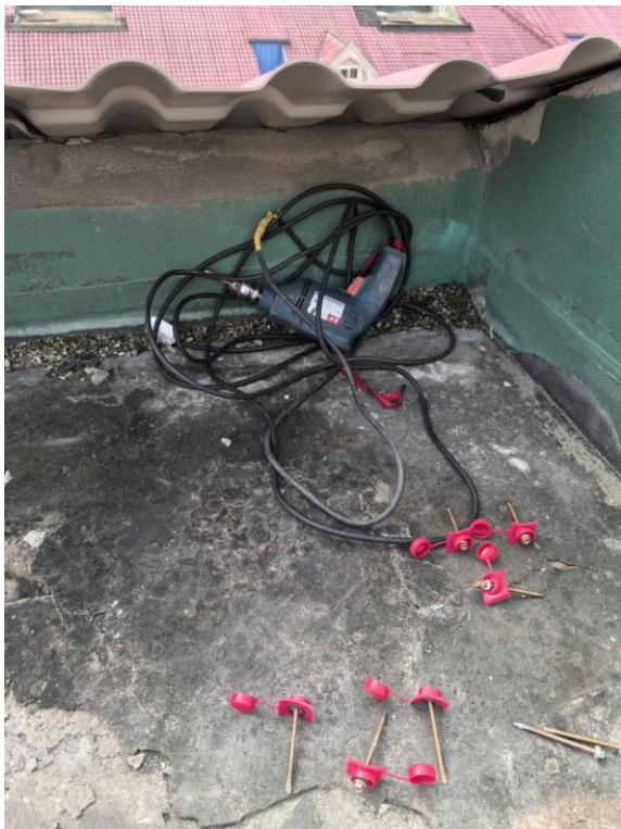
图五 屋顶遗留工具等照片
