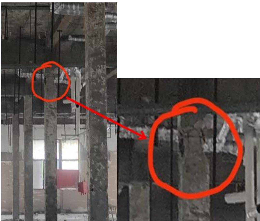
图 3 12-C 轴柱顶呈轴压破坏
