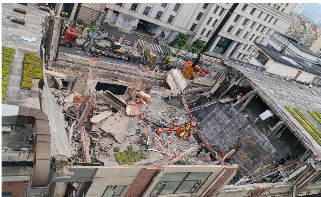
图 5 坍塌区域初始状况
