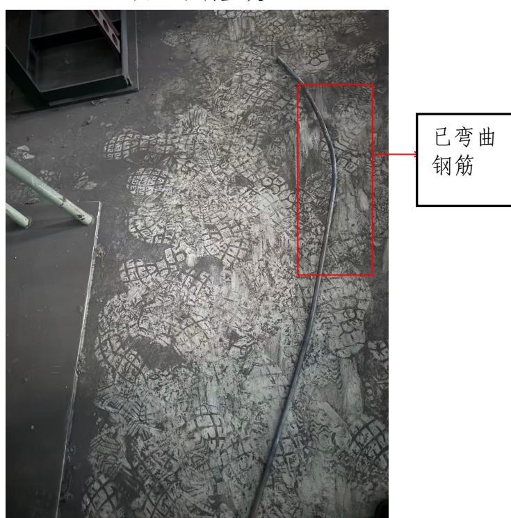
图10 液压机旁已弯曲的钢筋
