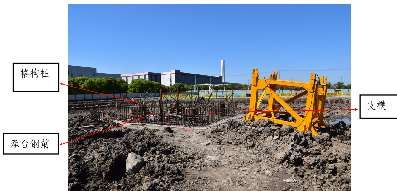
图 4 事故现场情况
