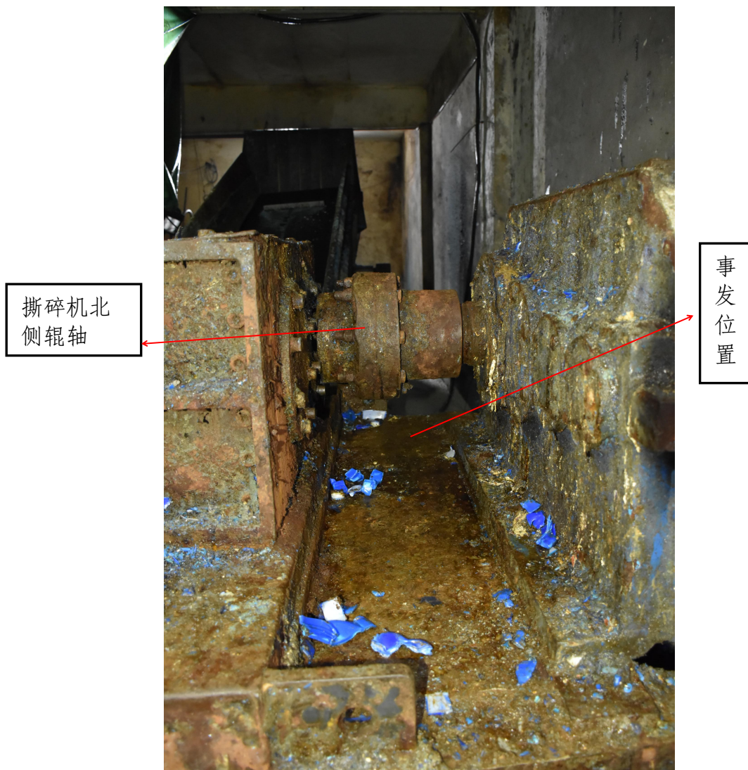
图6 事故发生位置
