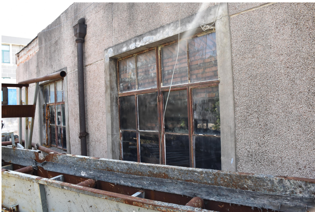
图16 厂房北侧窗户均用砖块封堵
