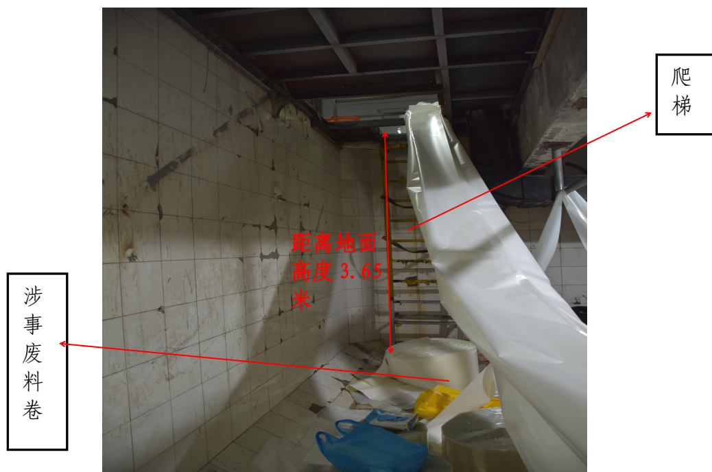
图5 涉事地坑情况
