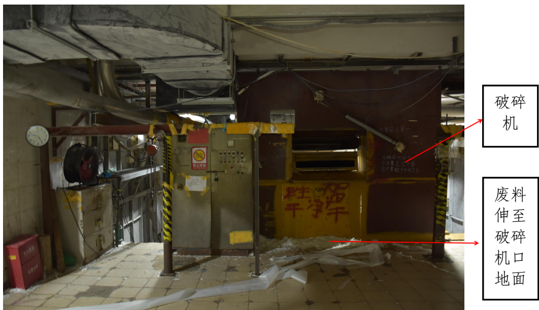
图9 地坑内废料处理机
