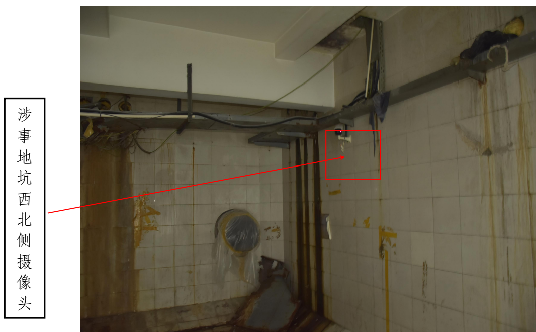
图10 地坑监控探头
