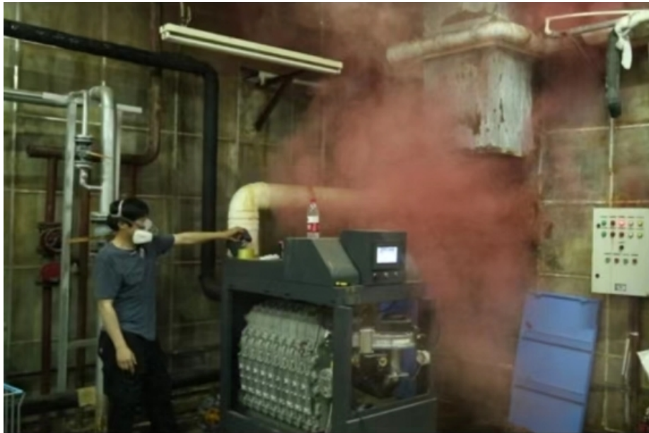
图5 金属板与墙体烟道贴合处存在缝隙
