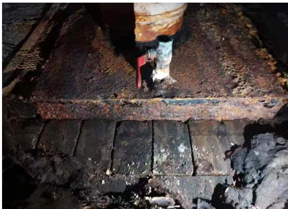
图 3 墙体与风道盖板密封处破损情况
