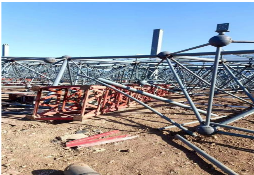
图 10 顶升支架未设置缆风绳，底部未采取固定措施
