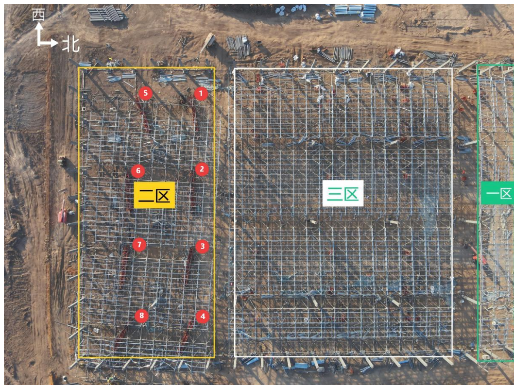
图 3 事故现场航拍图 (黄色框线内是焊接车间二区、红底白字表示八个顶升支架的布置位置)
