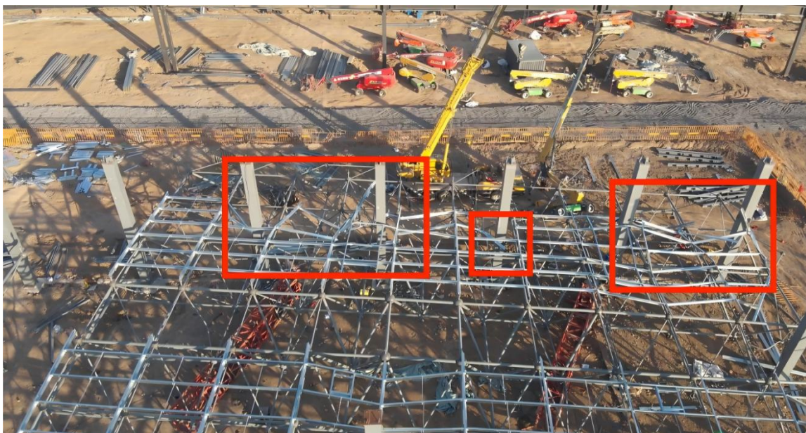
图 4 网架局部变形破损（红色框线内）
