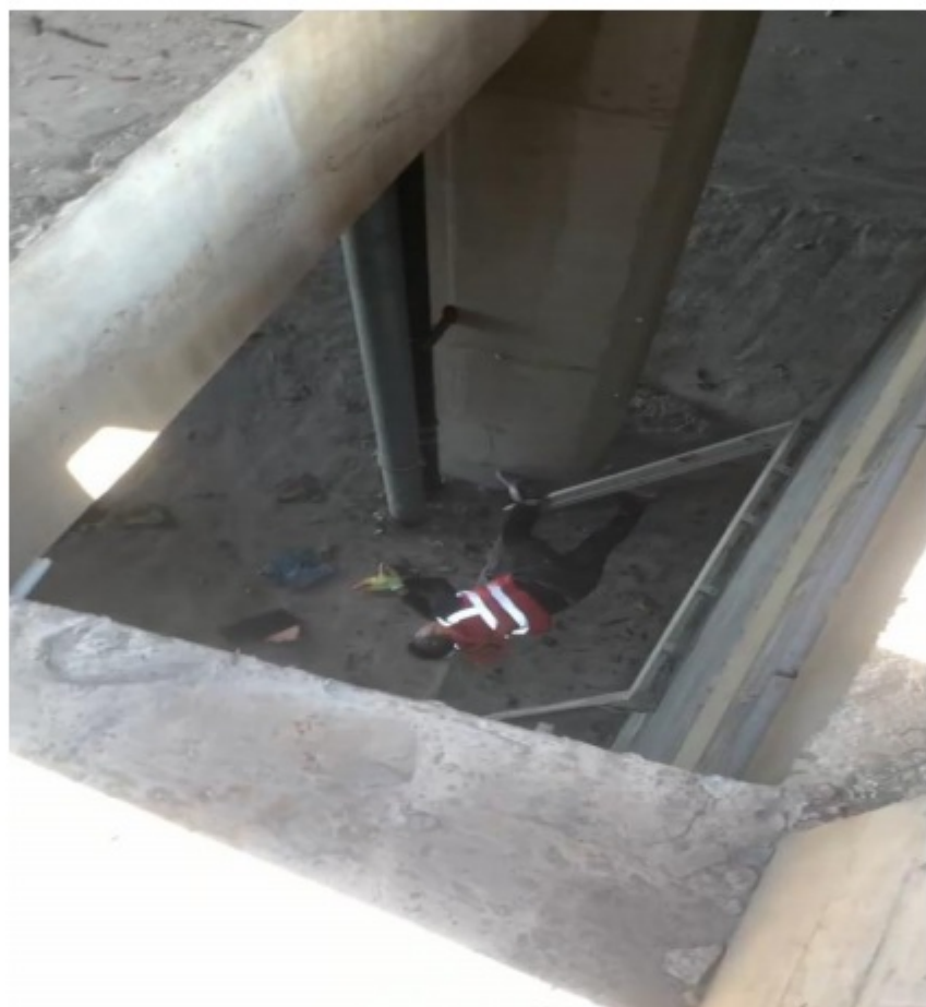
图6 事故现场照片
