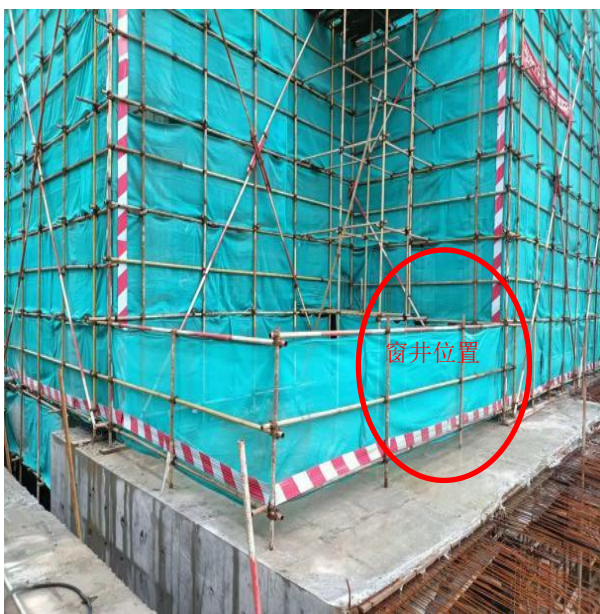
事发窗井洞口周围的车库顶板
