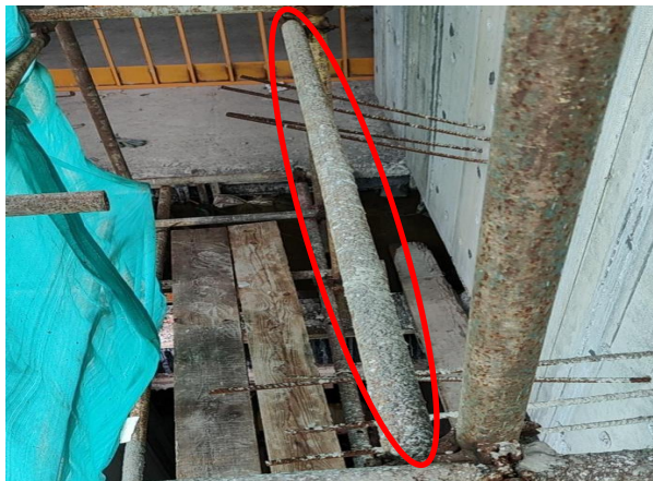
应该悬挂安全带的钢管上无痕迹 (四) 事故当天天气情况
