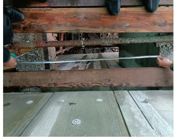
窗井洞口未覆盖盖板部位 长度方向 110cm
