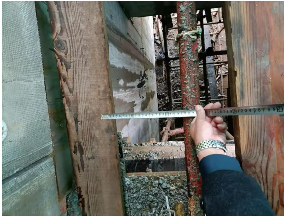
窗井洞口未覆盖盖板部位 宽度约为 24cm
