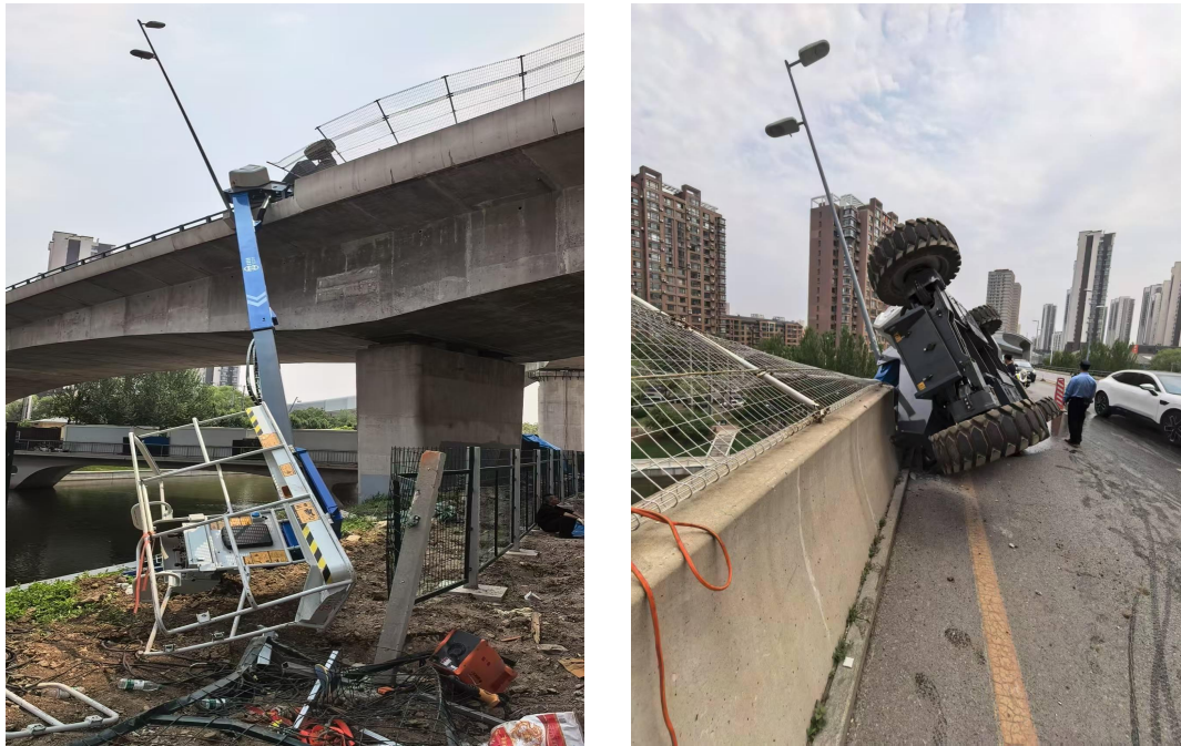
图 5/图 6 直臂式高空作业平台事故现场
