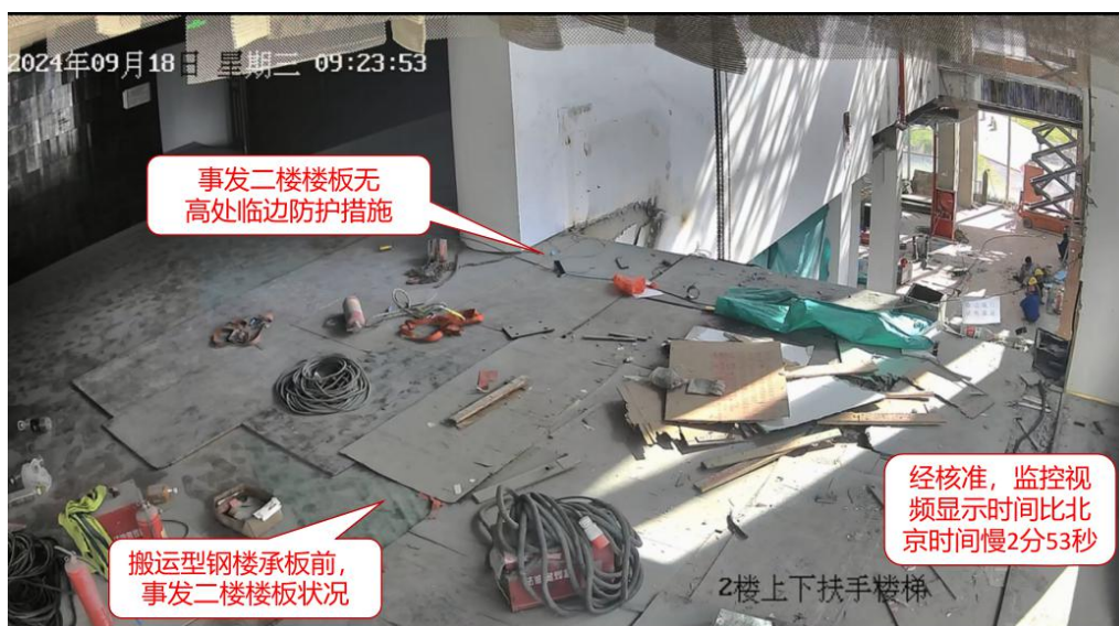
图3 事发前二楼楼板状况和高处临边防护措施状况视频截图
