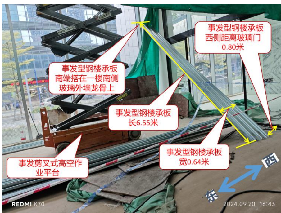
图 14 事发型钢楼承板勘查图
