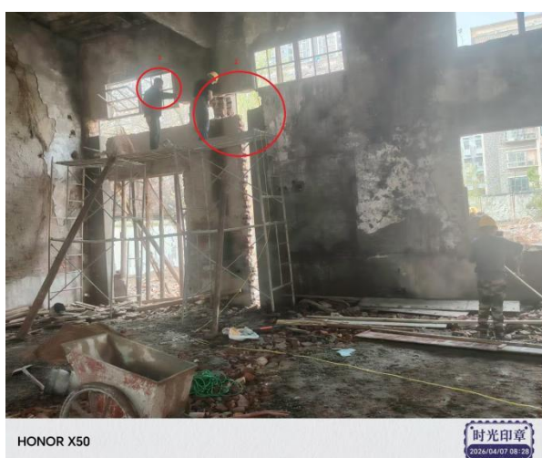
图5：事故发生当天现场照片
