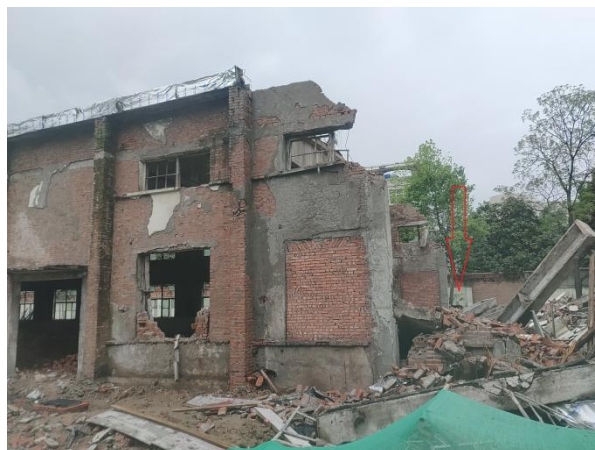
图2：现场坍塌情况视角2
