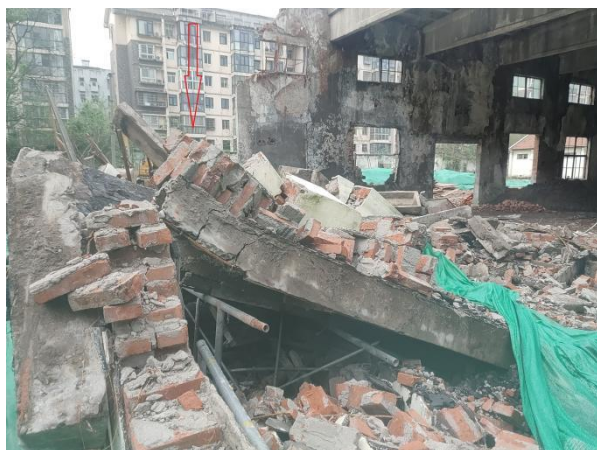
图1：现场坍塌情况视角1
