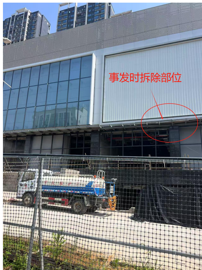
图 4 事发工地现场照片
