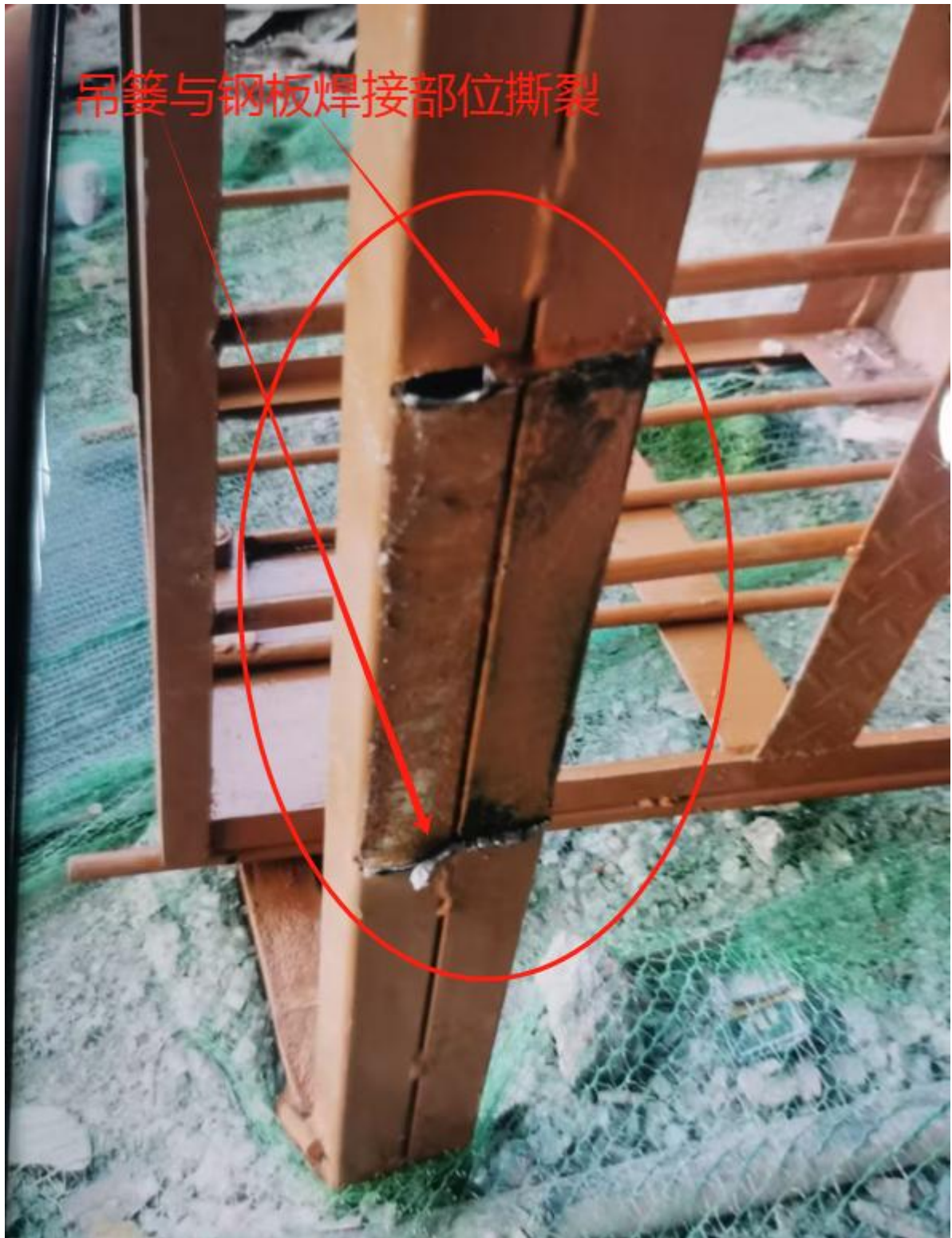
图 3 吊篮焊缝撕裂位置
