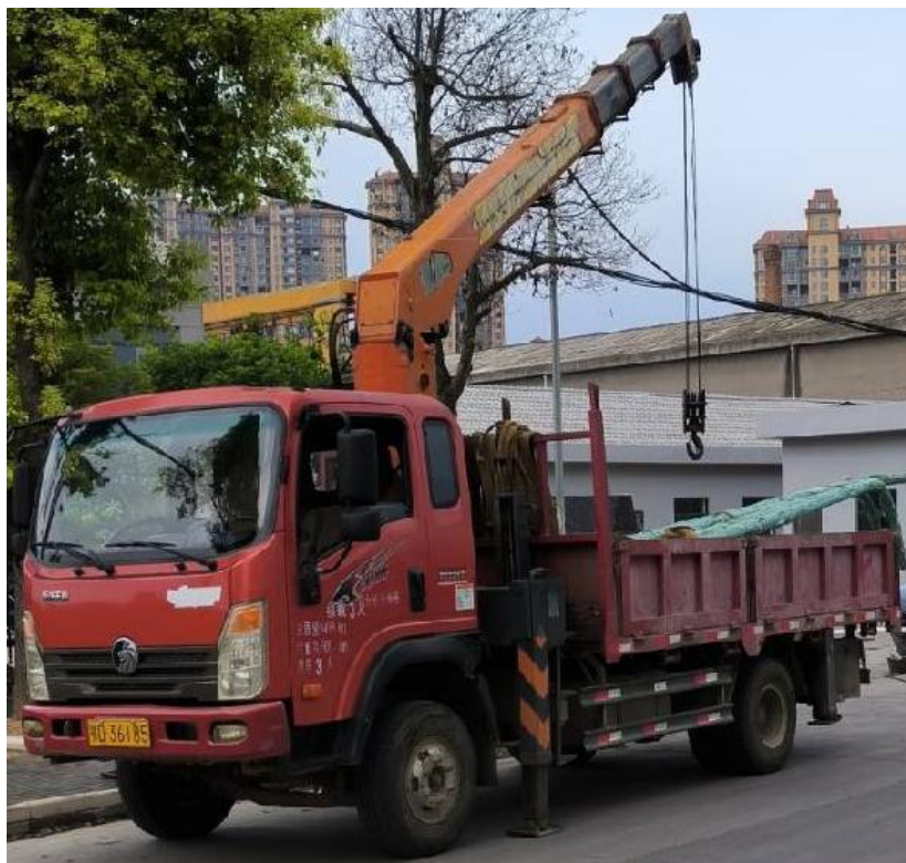
图1 涉事随车吊全貌
