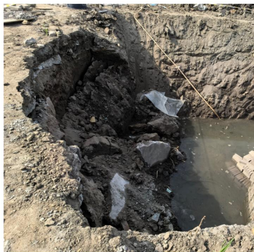
(b) 4月9日坍塌处形貌
