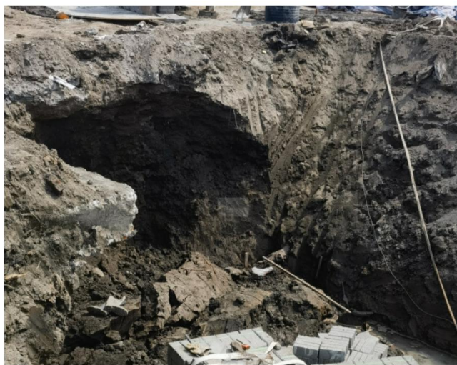
(a) 4月3日坍塌处形貌
