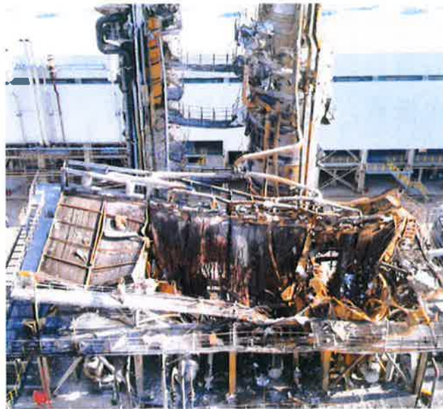
图 2 事故现场情况
