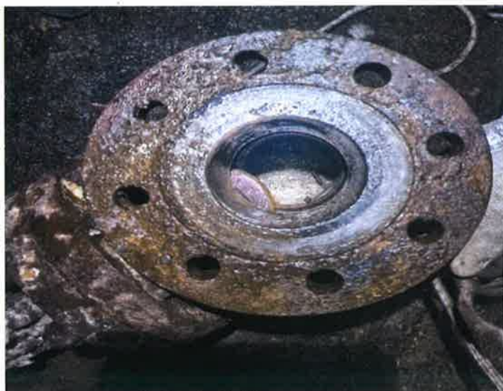
图 3 脱丁烷塔底密排、明排管线引出阀开度状态
