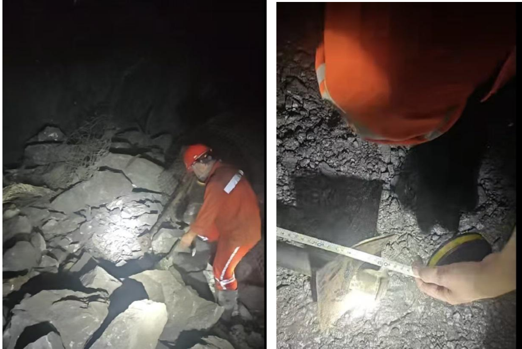
图 3（b）垮塌区锚杆测量图
