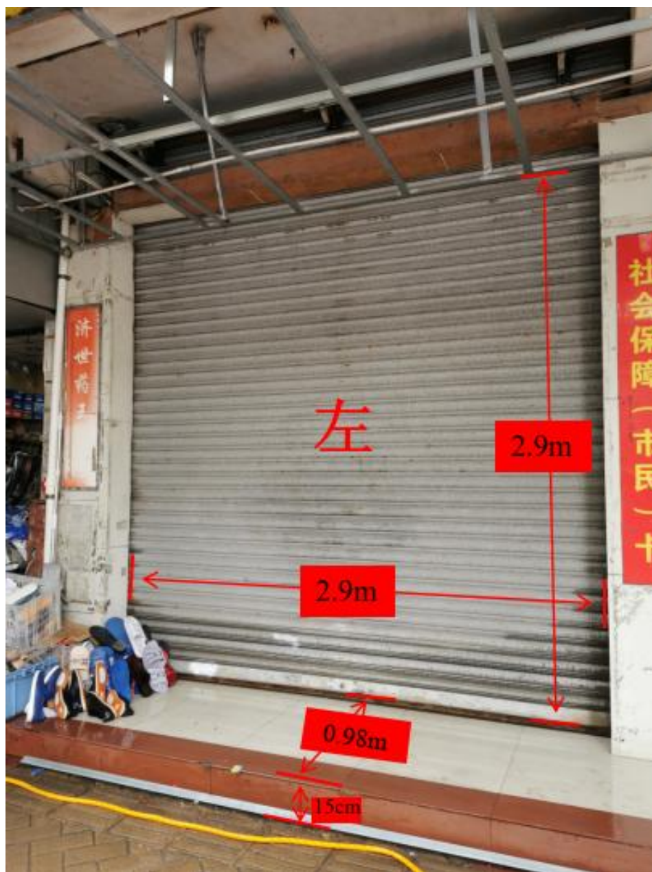
图 1 事故现场照片
