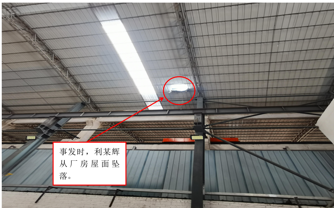
图 2 事故现场情况
