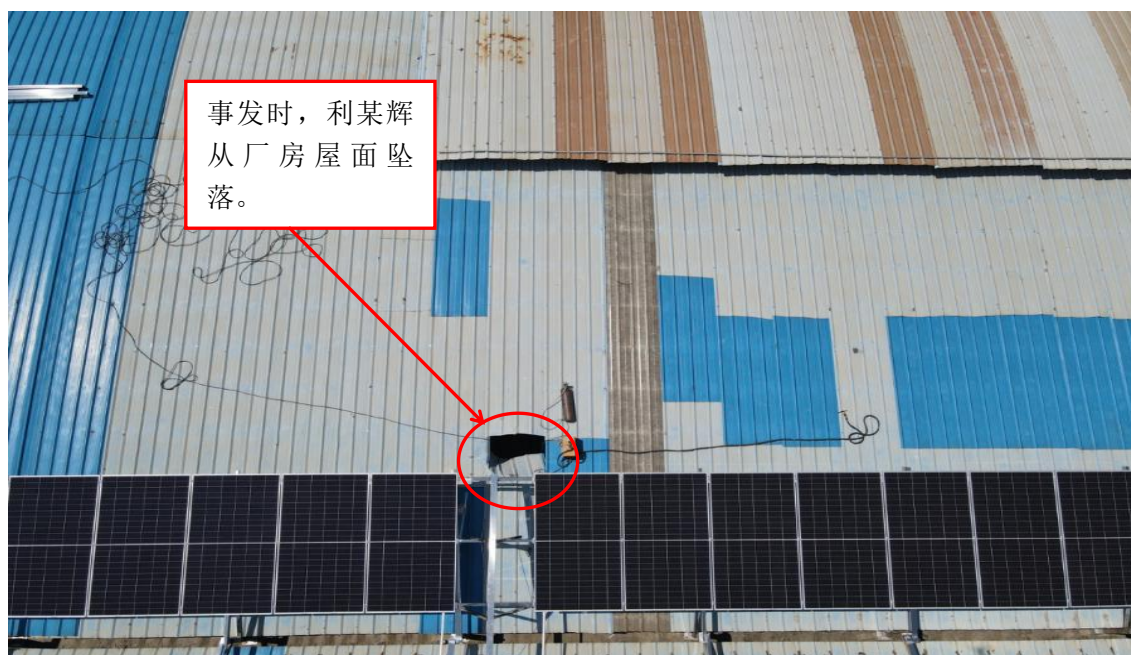
图 1 事故现场情况
