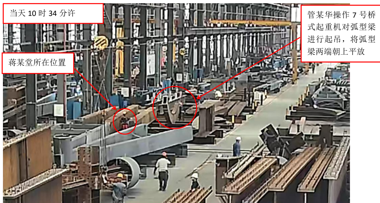
图 2 事故现场监控视频情况
