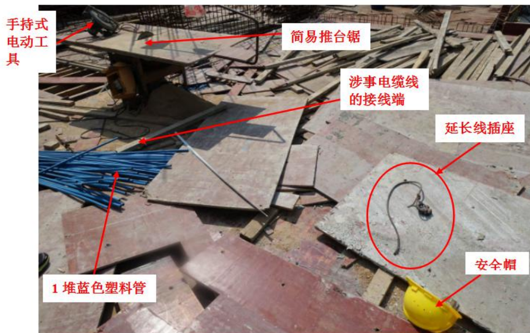
图一 武菱汇苑 17#楼负一层顶板处情况
