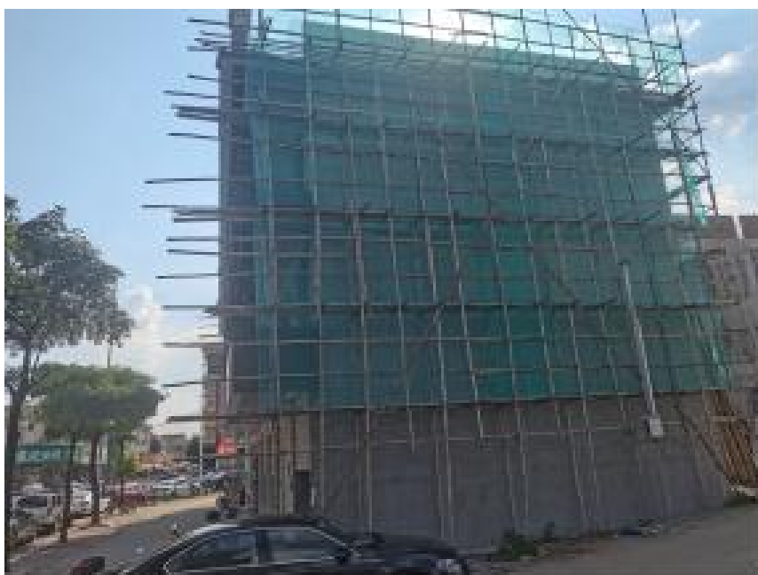
▲ 图 2：事发现场（第九栋自建房侧面竹木棚架情况，防护网是发生事故后挂上）
