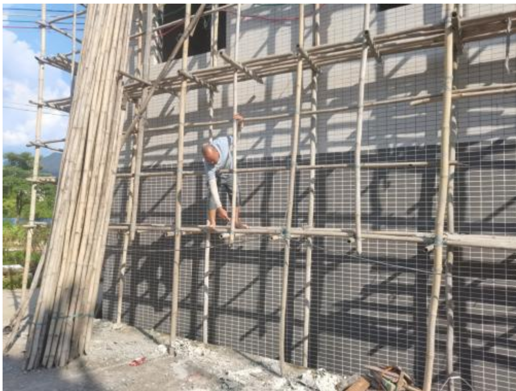
▲图 3: 黎*文在自建房背面竹木棚架桥上模拟黄*培站立竹木棚架桥上弯腰用镰刀拆断竹木棚连接绳动作（事发时黄*培站立的竹木棚架桥上方横向竹木已拆除，站立点以上无横向竹竿）
