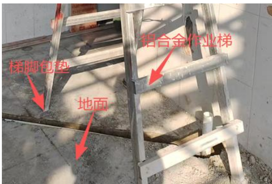
图 2 梯脚包垫和地面情况
