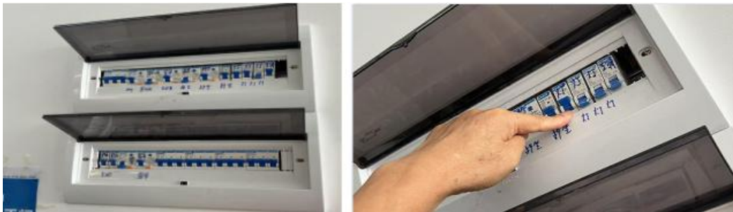
图 7 施工时原有供电箱
