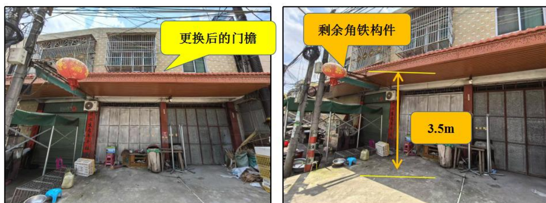
图 1 事故现场勘查情况
