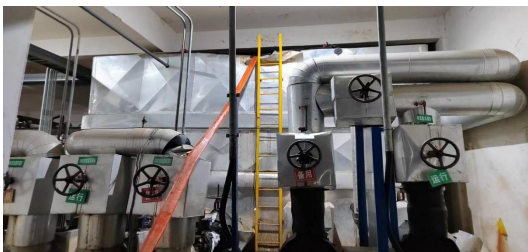
图 4 事故冷冻盐水箱（由南向北拍摄）
