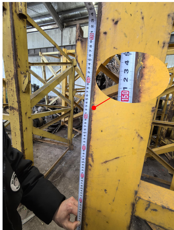
图 4 B 组钢材高 1.53 米处碰撞痕迹照片
