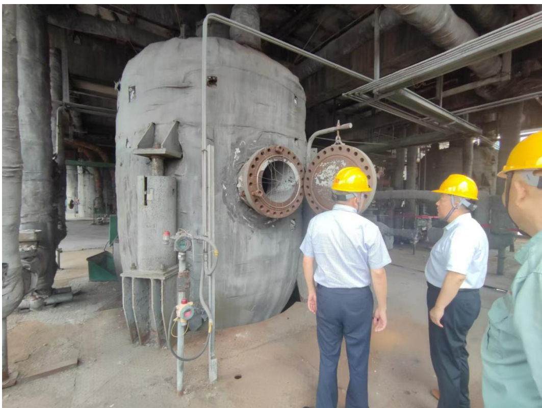
图 1 安徽昊源化工集团有限公司事故厂区气化装置区渣锁斗 B 现状图
