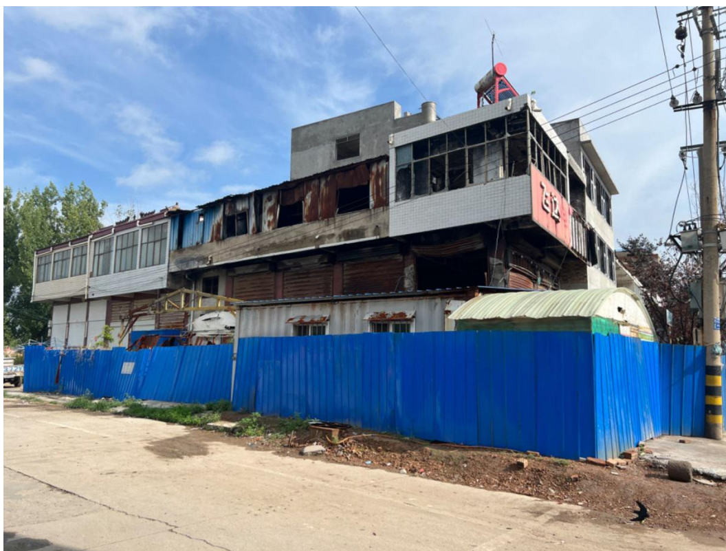
图 1 事故过火建筑现状图
