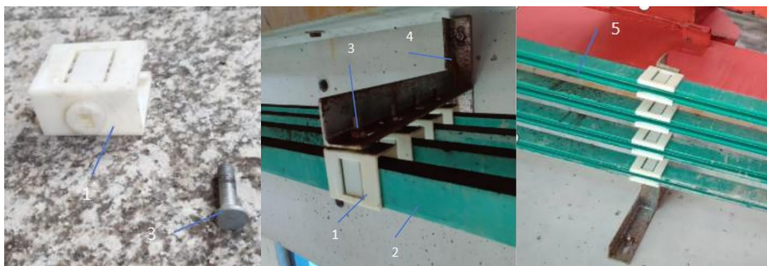
图 3 事故作业点及维修配件
