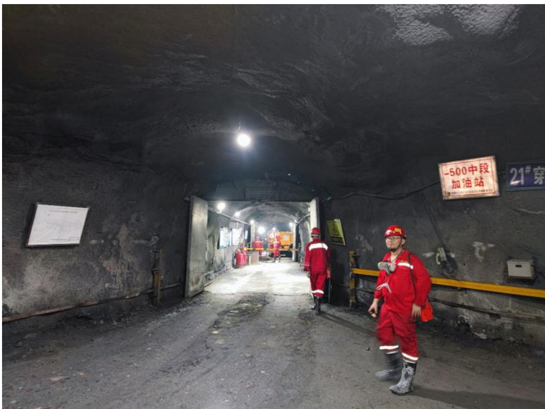
图 2 重新集铁矿新建-500m 中段加油站
