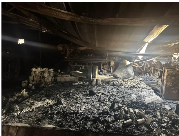
图 2 事故现场照片
