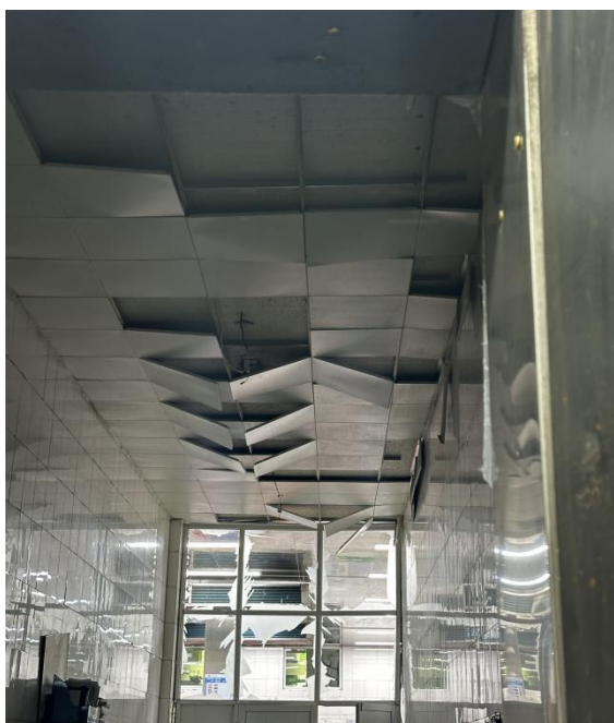
图 1：爆炸后的储气罐间
