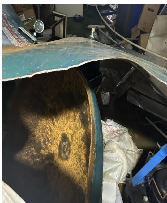
图 2：裂开的储气罐罐体
