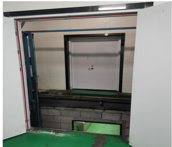
图 2 二楼高处坠落点
