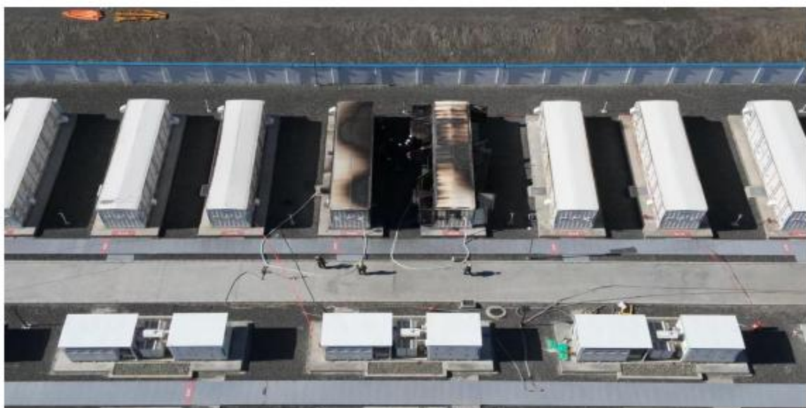
达金工 B 区储能一电站 3-7A 电池舱
