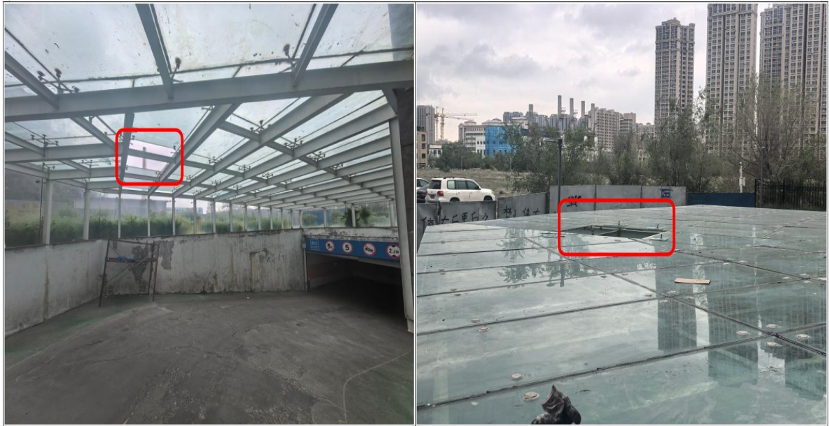
图 1：事故现场（丽都雅居 1#楼地库雨棚上下部）
