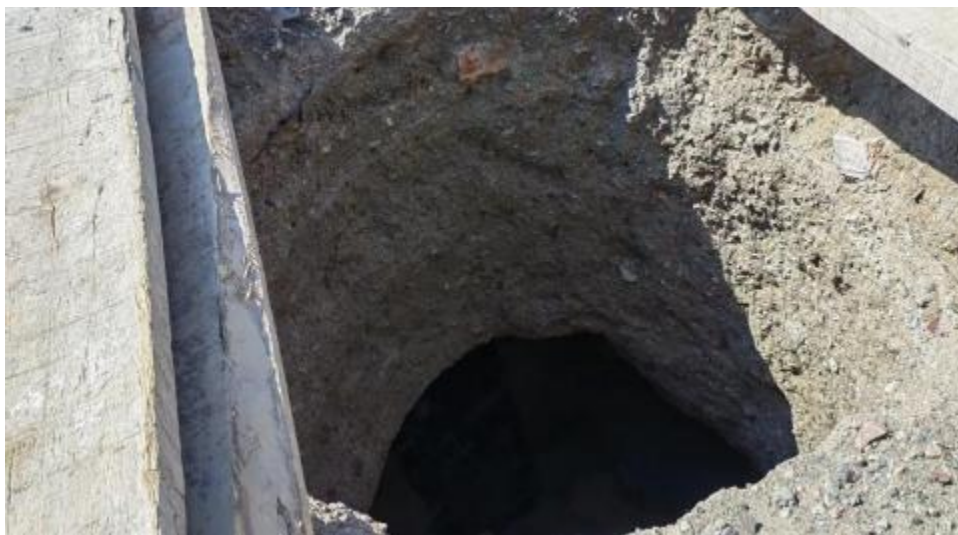
事故发生孔内坍塌探井照片
