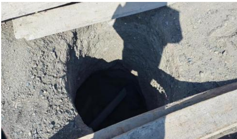
事故发生孔内坍塌探井照片
