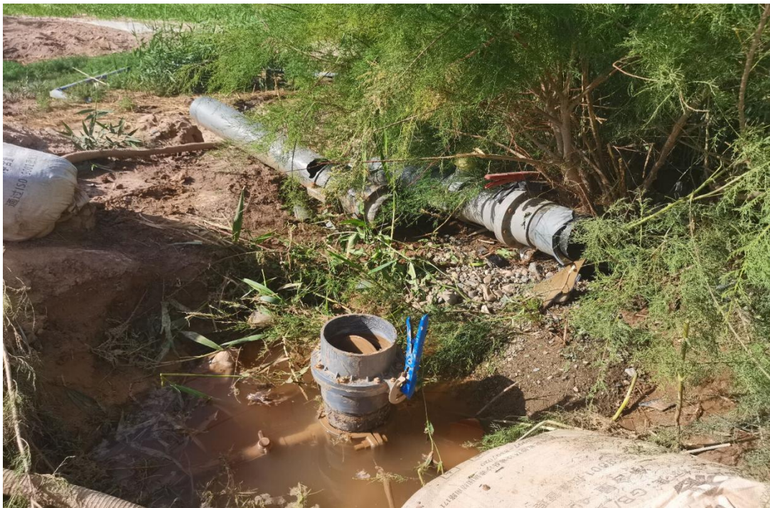
滴灌出水口阀门爆裂处
