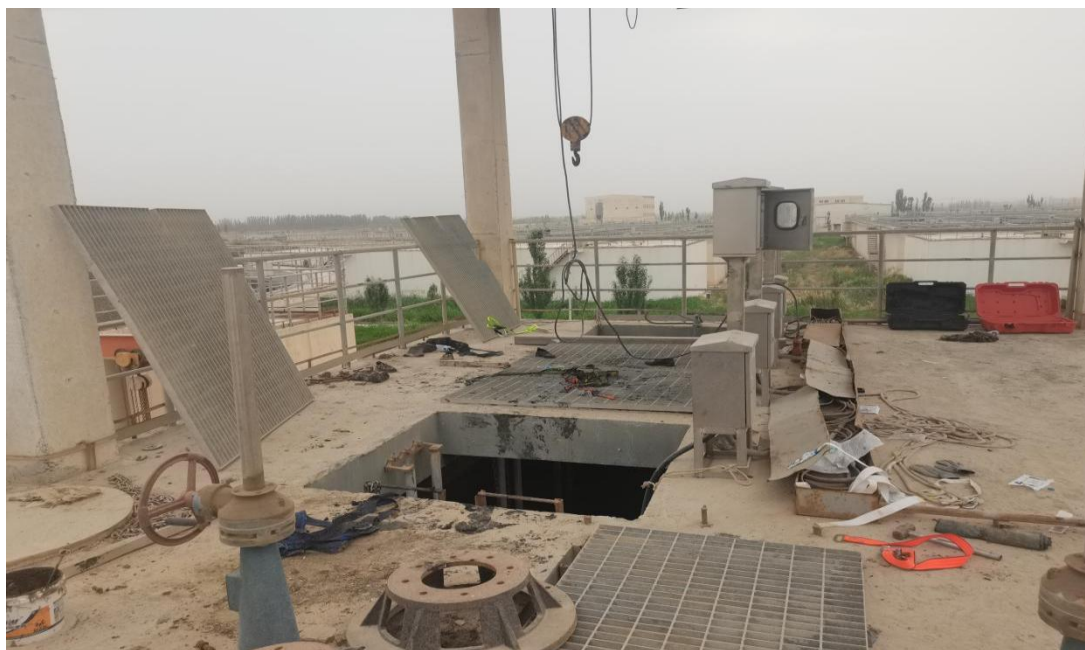
8号中沉池污泥泵井入口图
