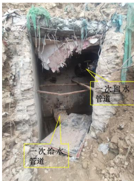
图8 阀门井内管道布置情况
