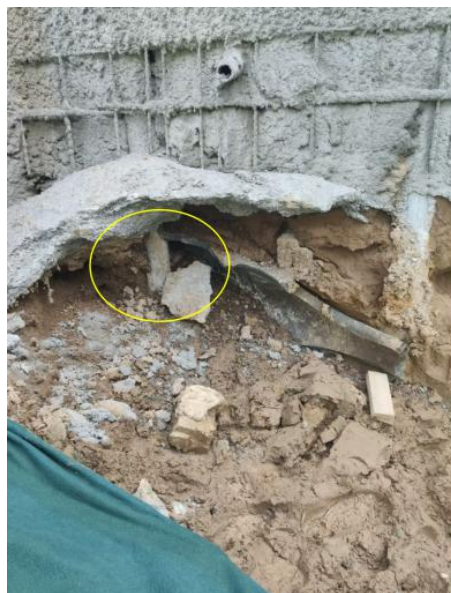
图 4 供热管道被打穿处
