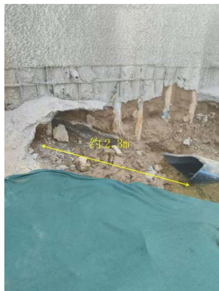
图 5 供热管道断口处
